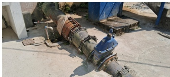
Foto 12 – Adutora de água tratada (DN 300), logo após o tanque, dotada de registro e tubulação de ventilação.
