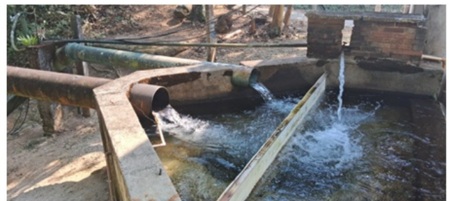
Foto 8 – Adutoras de água bruta, sendo uma metálica e outra de MPVC, desagando na caixa de tranquilização.
