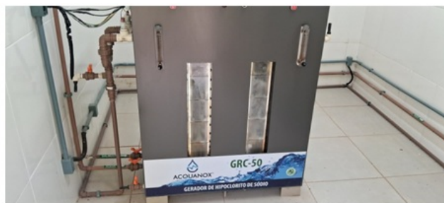
Foto 16 – Gerador de hipoclorito de sódio.
