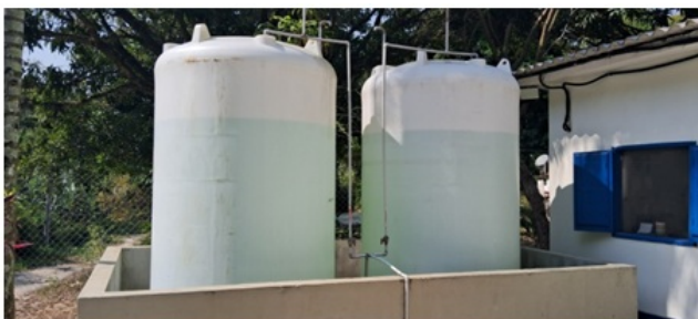
Foto 19 – Tanques de armazenamento do hipoclorito de sódio instalados em diques de contenção. Nota-se ausência de identificação.
