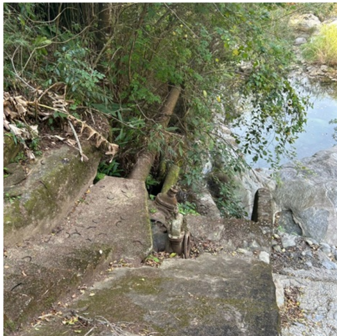
Foto 4 – Adutora de água bruta e registro de descarga. Nota-se necessidade de reparo na pintura.
