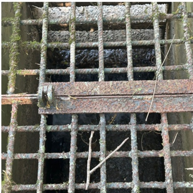
Foto 3 – Grade de inspeção sobre o desvio da captação. Nota-se necessidade de reparo na pintura.
