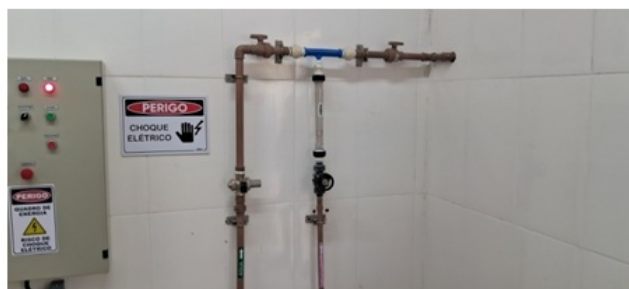
Foto 18 – Equipamentos de dosagem do hipoclorito de sódio.
