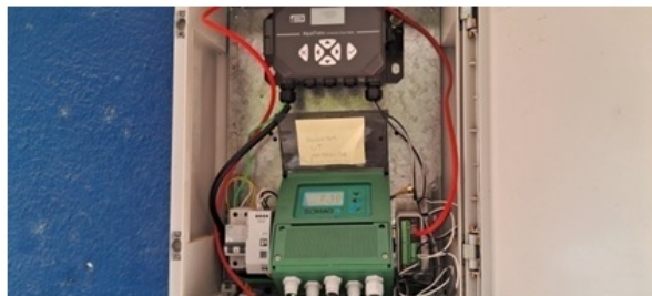
Foto 14 – IHMs dos medidores de vazão.
