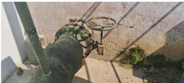
Foto 13 – Adutora de água tratada, logo após o tanque. Nota-se processo corrosivo na válvula e conexão e crescimento de vegetação na parede do tanque.
